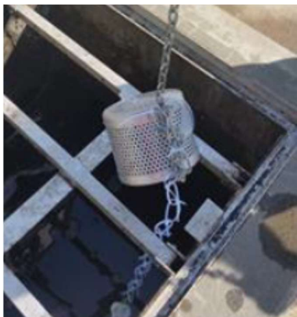
Figure 16 - Point de mesure sortie Biostyr
