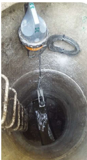
Sonde de mesure de hauteur d'eau
