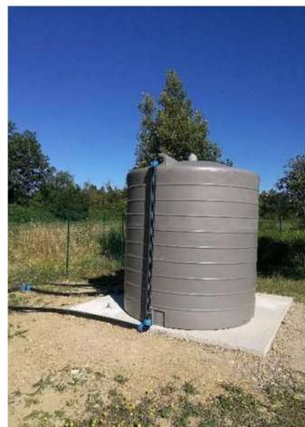
Figure 9 - Citerne de stockage des EUT installée sur la STEU de Saint-Drézéry
