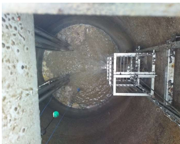
Figure 2 - PR Village - Saint-Drézéry - cuve avec panier dégrilleur
