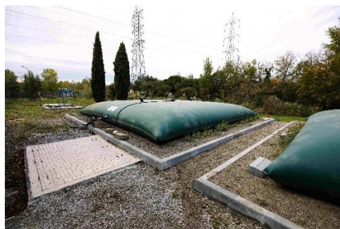
Bâches de stockage
